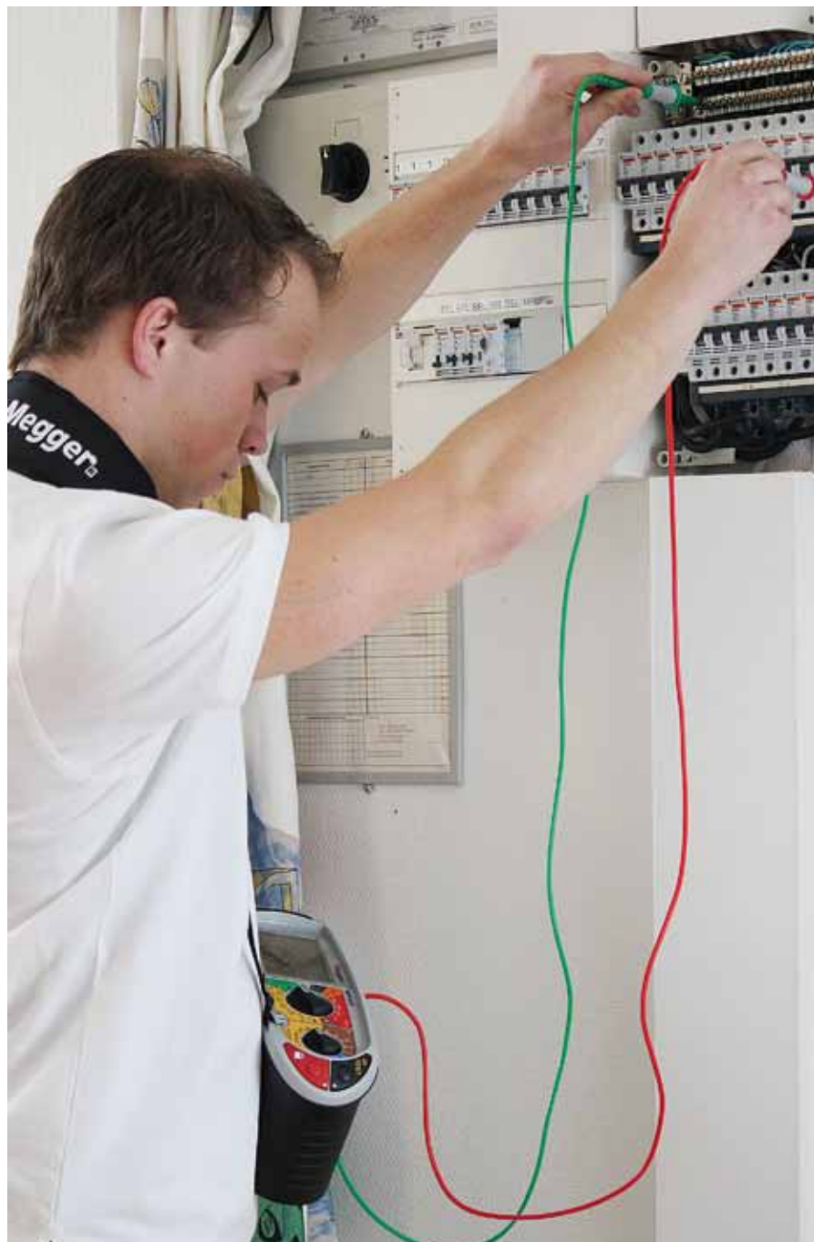
Elinstallatören ska se till att det berörda arbetet kontrolleras i betryggande omfattning.
