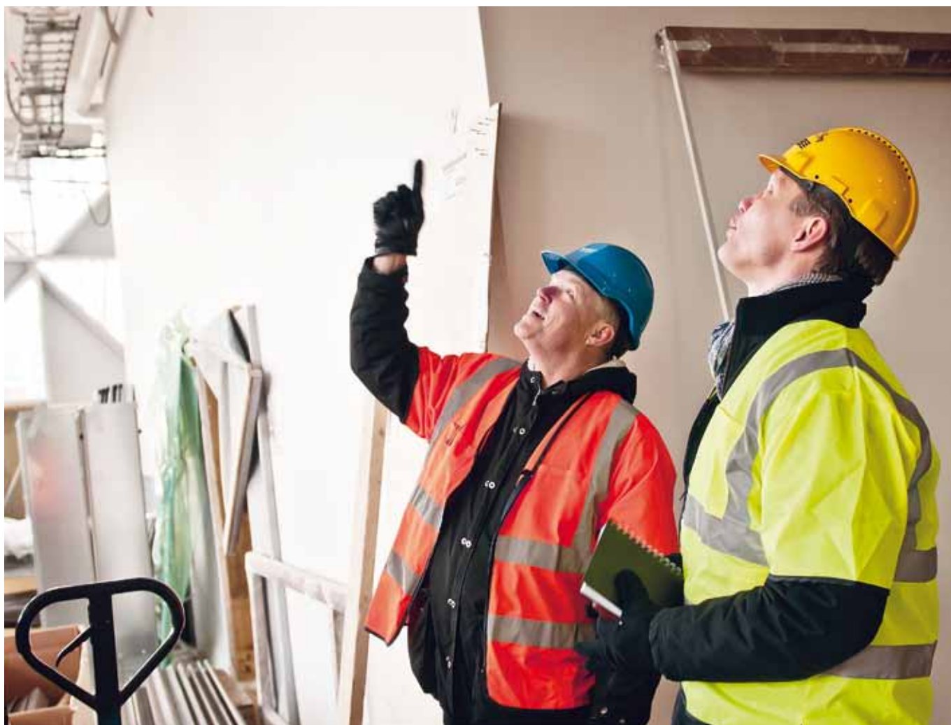
Ragnar Pedersen, säljare på ABB och YIT:s projektledare Kåre Persson inspekterar installationerna av strömställare och vägguttag i Victoria Tower, Kista.
