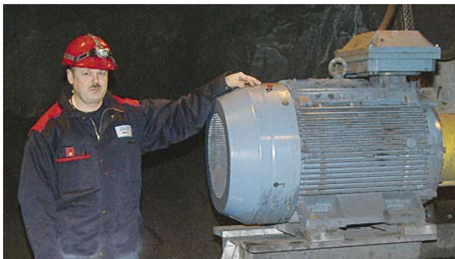
Lennart Kruuka, mätningenjör på LKAB, har stannat till vid en 132 kilowatts motor som driver en tryckstegspump i den tuffa miljön i pelletsverket KK3 i Kiruna. – Det är väldigt stryktåliga motorer, säger han.
