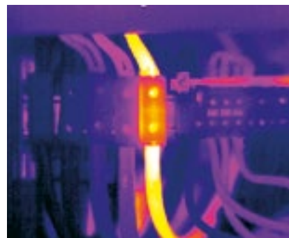
Termografering är en självklar del i elsäkerhetsbesiktning.
