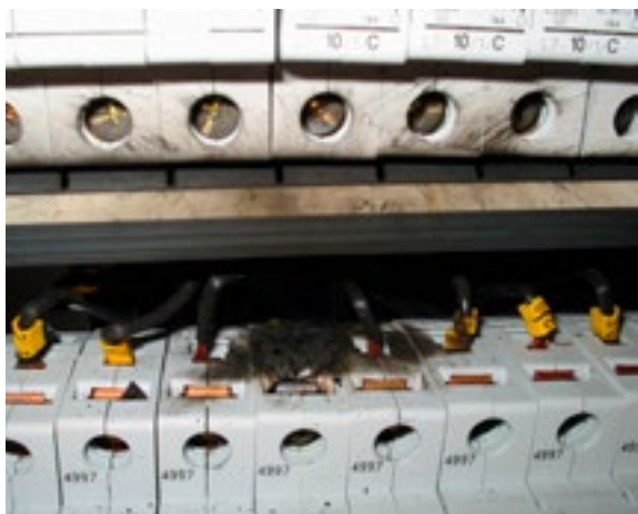
Glappkontaktsskada i en anslutning till en dvärgbrytare.
