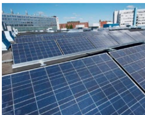
ABB Solar Power Plant, Helsinki Foto: ABB
