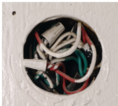
Dosa utan lock – färgen på ledarna (röda ledare) vittnar om att installationen är mer än 60 år gammal. Färgen, den vita vittnar om att lock saknades vid målningsarbetet.
