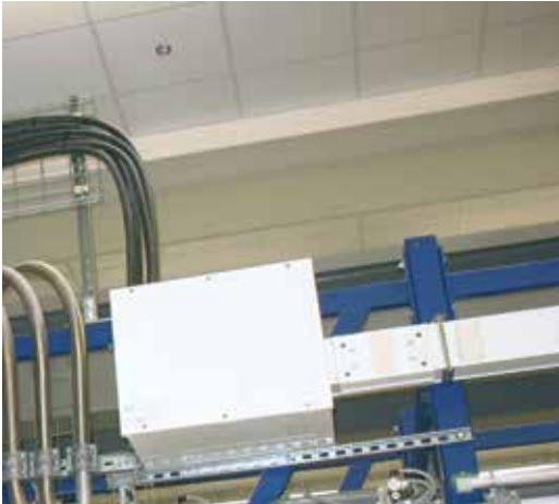
Canalis KS och sprinkler.
