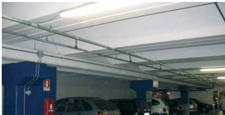
Canalis KBA som matar armaturer i närheten av en sprinkler.
