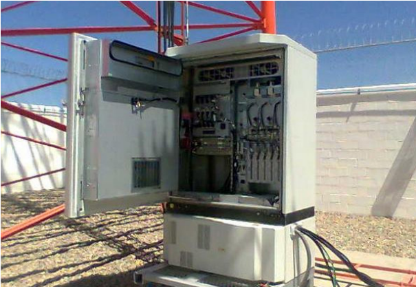
Överspänningsskydd för radiobasstation.
