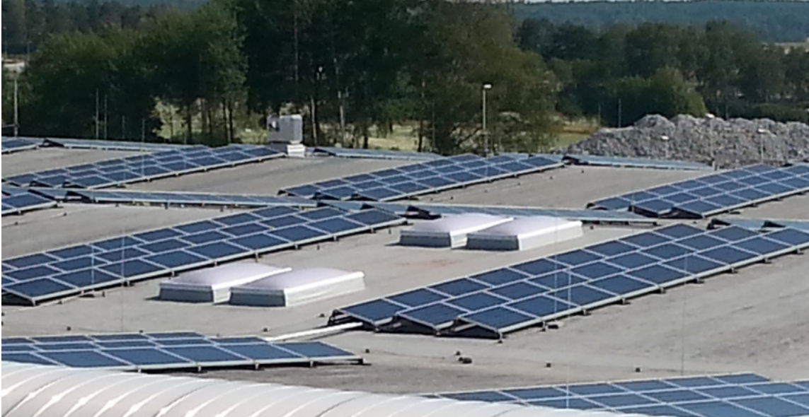
Åskskydd av solpaneler norr om Stockholm.
