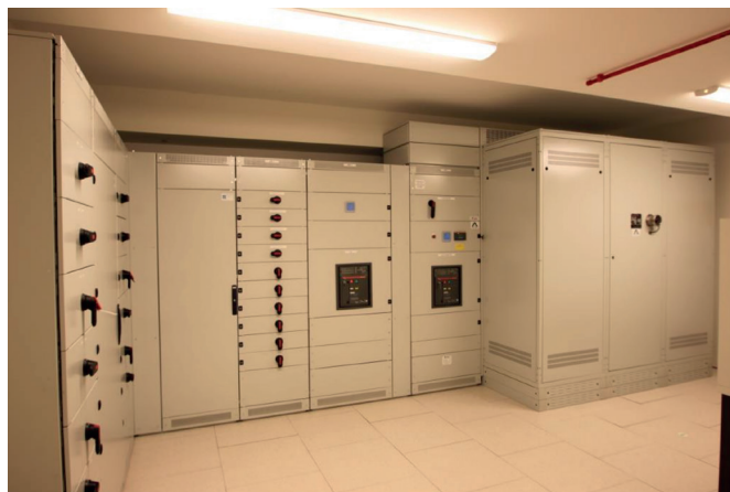
Bilden är ett exempel på ett elrum. Ställverkets dörrar kan inte öppnas utan användning av nyckel eller verktyg och spänningssatta delar är oåtkomliga.
