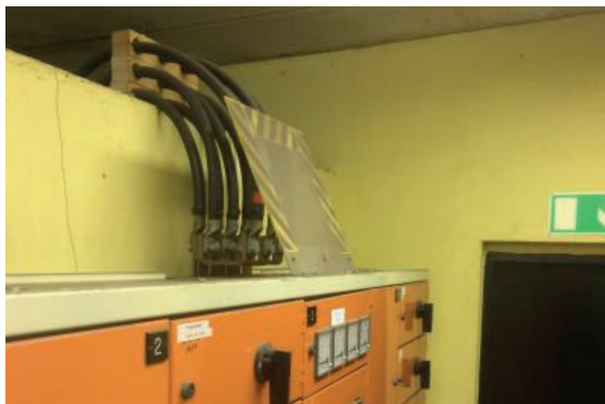
Bilden är ett exempel på ett driftrum. Anslutningar skyddas genom hinder.
