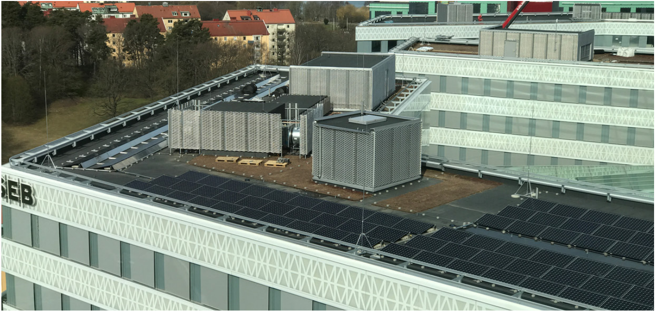
Åskskydd av solpaneler norr om Stockholm.
