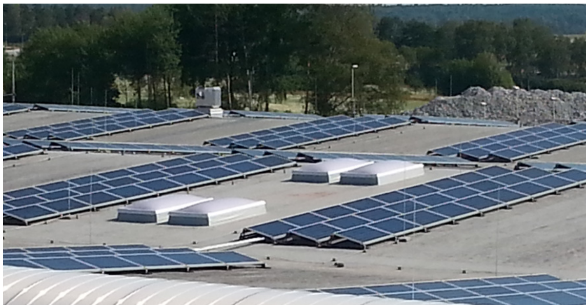
Åskskydd av solpaneler norr om Stockholm.
