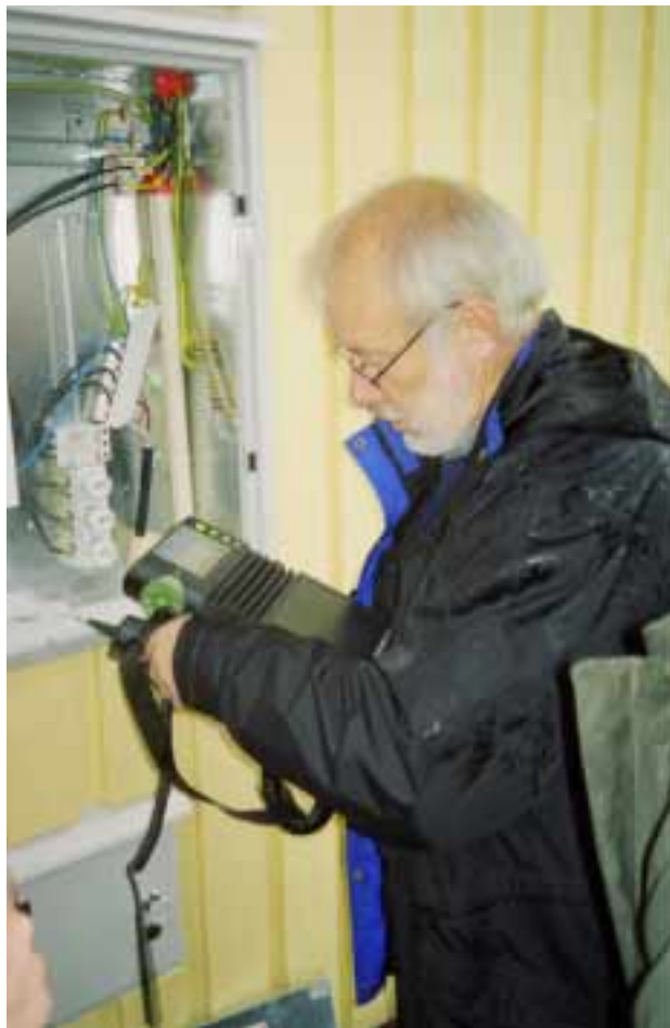
Bo Hammarberg från Elsäkerhetsverket var en av dem som inspekterade en nybyggd villa i Järfälla och fann flera bristande elinstallationer, bland annat i fasadmätarskåpet.
